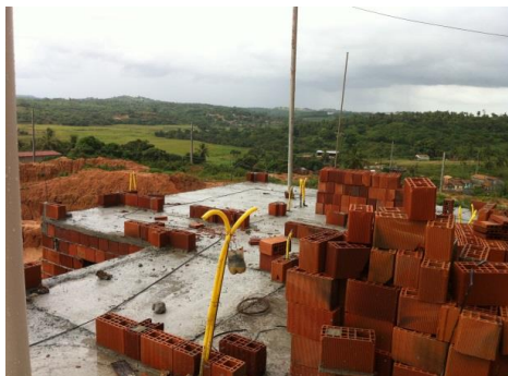
Foto 08: periferia sem guarda-corpo
