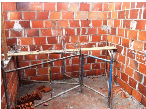
Foto 05: andaime não regulável montado de forma triangular (e não retangular)
