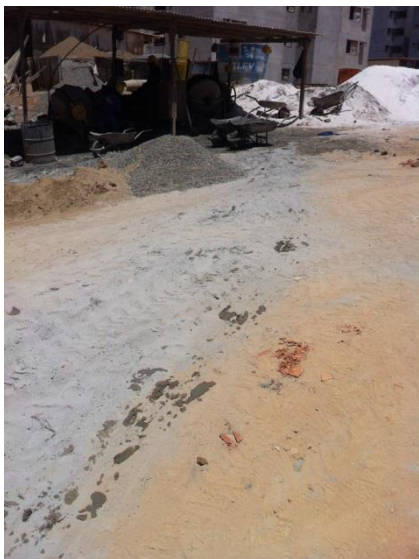
Foto 28: Desperdício de argamassa durante transporte
