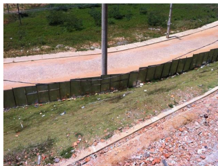
Foto 12: terreno irregular / sujeiras ocasionadas pela quebra de blocos.
