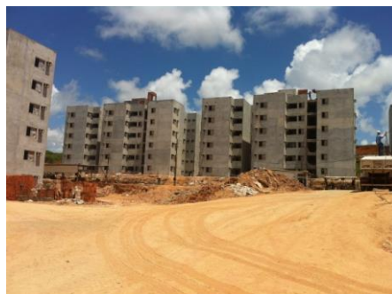
Foto 02: Foto geral da obra (vias de circulação obstruídas).
