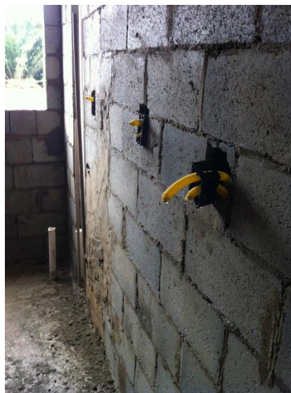
Foto 02: caixas chumbadas somente após a alvenaria pronta. Ver observação 22.
